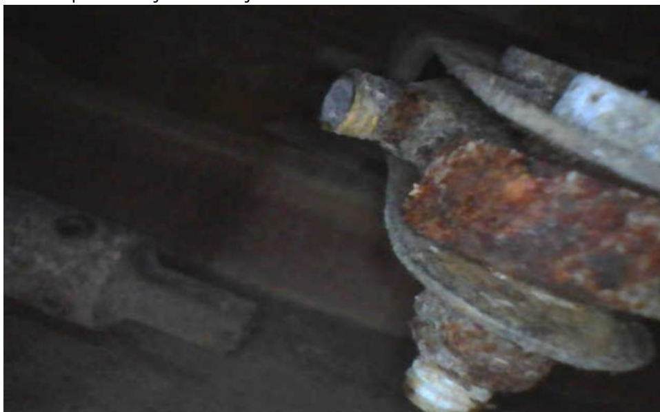
Kuva 1 Ruostunut ja katkennut työntötangon pää
